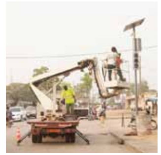
54 | Feux de signalisation solaires
